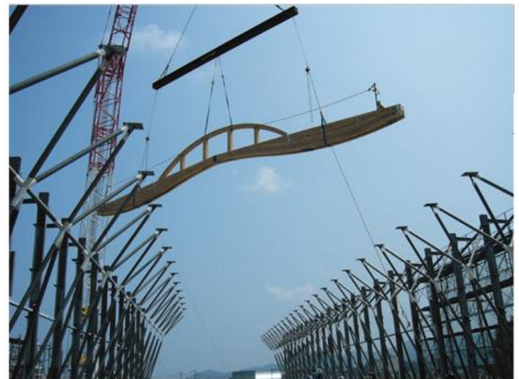
□建て方：鉄骨で支えられた屋根は多くの市民が手を差し伸べているようでもある。
