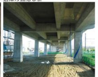
□高架構造：高架下を有意義に使うために、スパンを21mとしている。鉄道高架では日本一の長さである。
